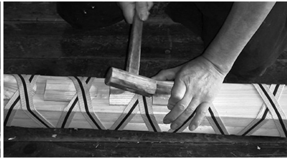
写真28 くさびを打ち込む
